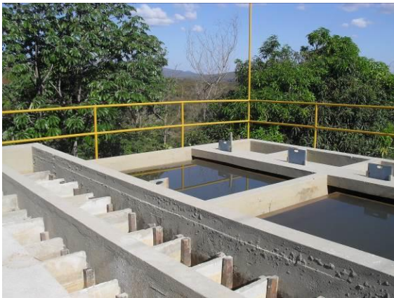
Foto 23 – Vista superior – floculadores e decantadores
